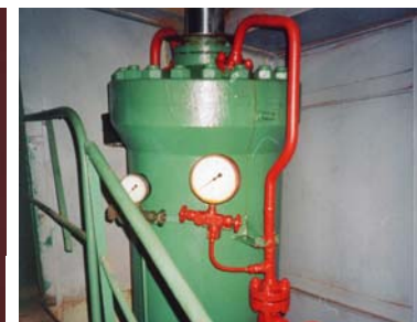
Гидропривод разводного раскрывающегося моста
