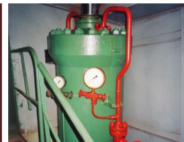
Гидропривод разводного раскрывающегося моста
